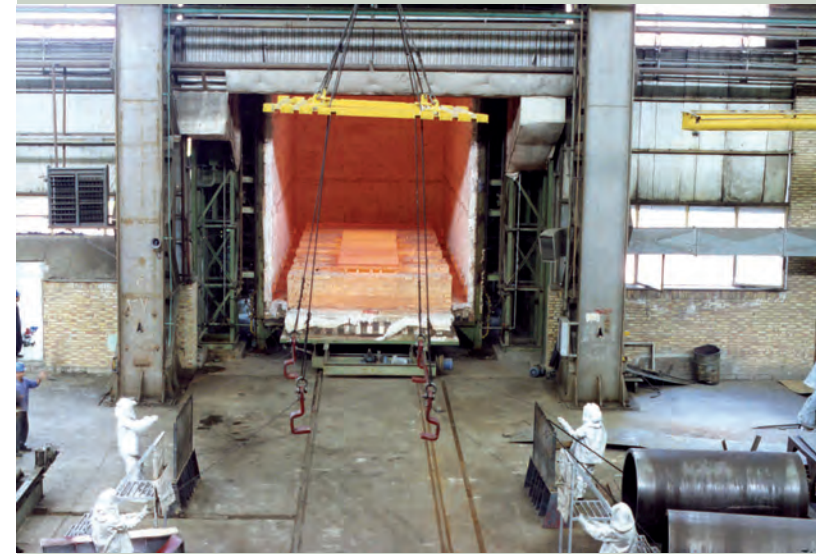
▲ کوره های عملیات حرارتی
