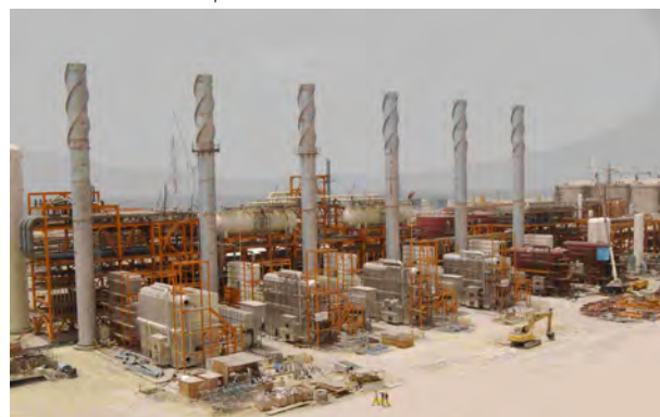
▲ بویلرهای پارس جنوبی فاز ۲۲-۲۴ ۶×۱۶۵t/h
